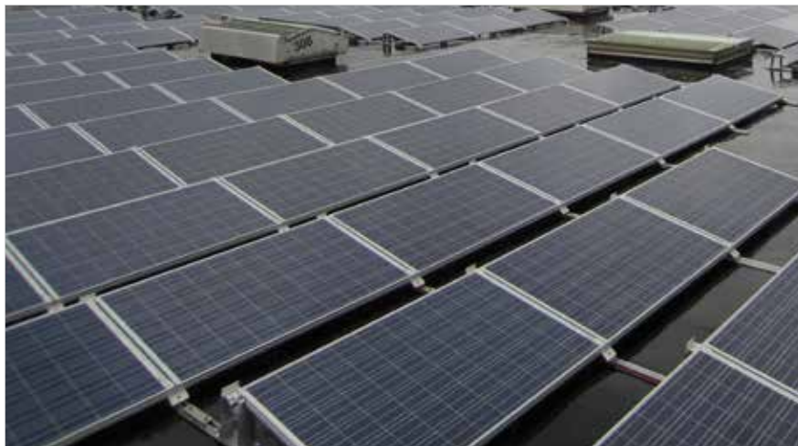
Kaiserslautern, Germania Instalație: 2,8 kW | Sistem S-Dome
