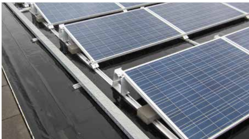
Kaiserslautern, Germania Instalație: 2,8 kW | Sistem S-Dome
